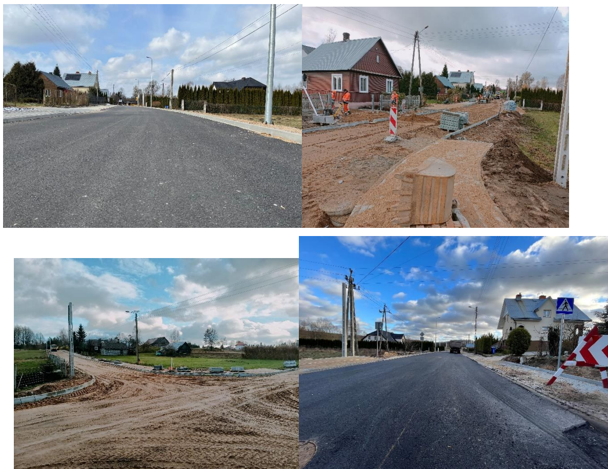
Zdjęcie 2. Przebudowa z rozbudową drogi gminnej nr 103678 ul. Polnej w miejscowości Kuźnica
